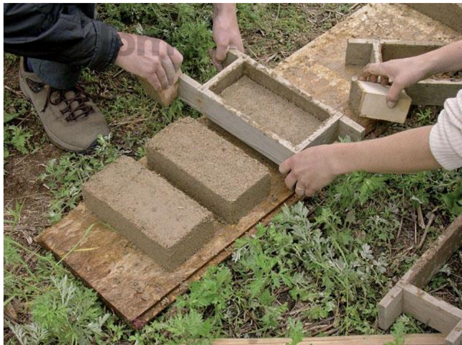
Ručná výroba nepálených tehál s pridaním prírodných vlákien (kúsky slamy alebo konopného vlákna). Výroba nepálených tehál je nenáročná na primárne energie a hlina je materiál, ktorý sa bez zvyšku a jednoducho recykluje. (zdroj: www.mojdom.zoznam.sk )
